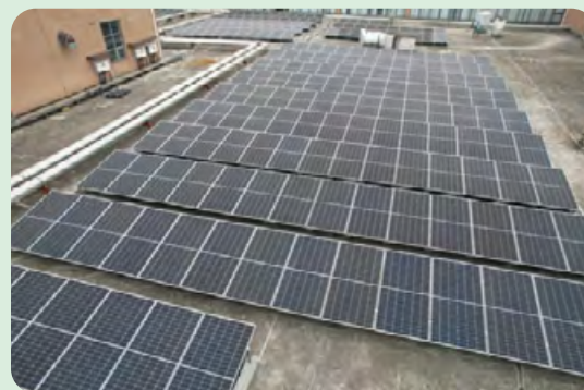
太陽能板發電系統建置 (東莞飛宏)
